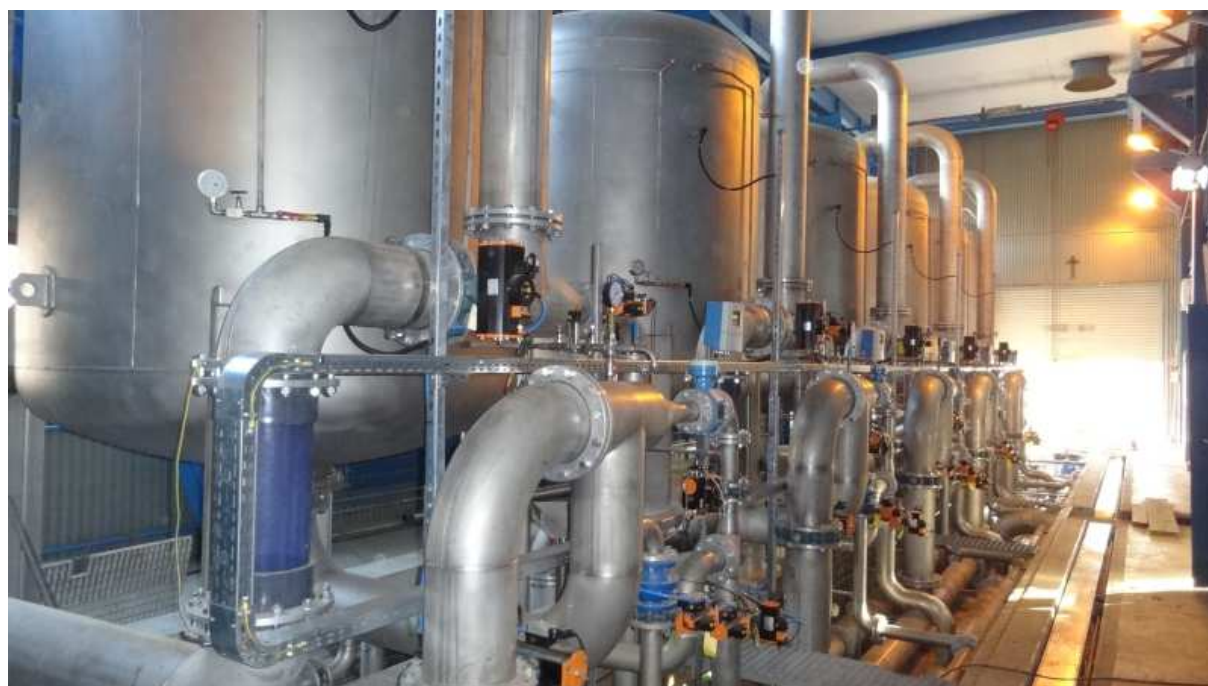
Rysunek 2. Stacja Uzdatniania „Leśna”- hala filtrów
